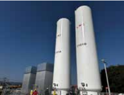
LNGサテライトタンク
