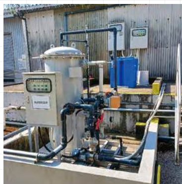
雨水ろ過装置
