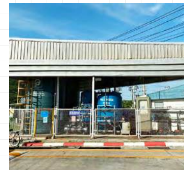
アユタヤ工場の水再生利用設備
