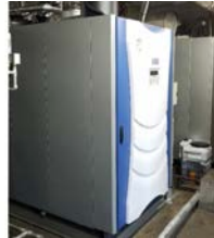
廃食油ボイラ
