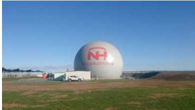
工場排水を利用したバイオガスプラント （オーキービーエクスポート（豪州））
