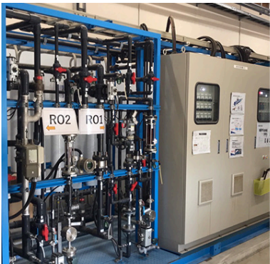
RO膜ろ過設備
