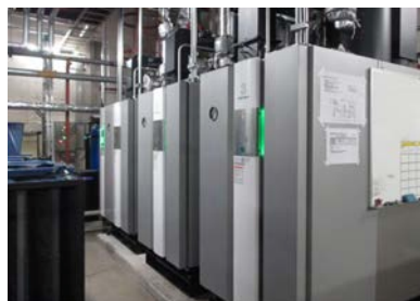
高効率ボイラ
