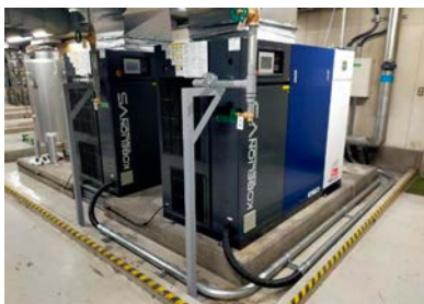
廃熱回収コンプレッサー
