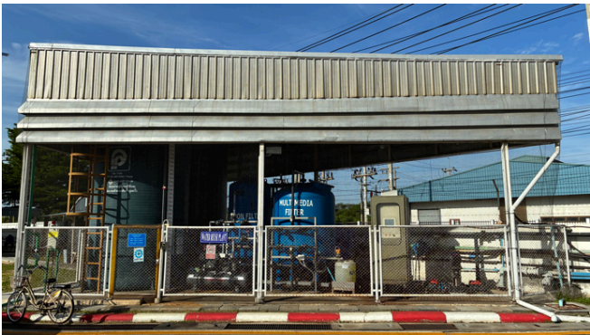
アユタヤ工場再生利用設備
