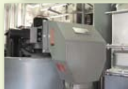
ボイラー吸気の活性化装置
