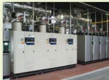
都市ガスボイラー
