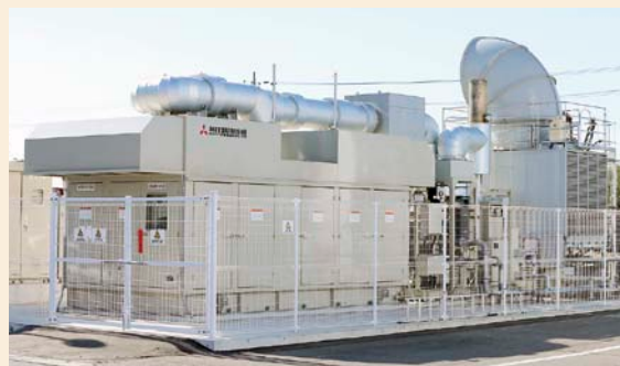
天然ガスを使用した自家発電設備
