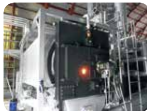
鶏ふんボイラー
