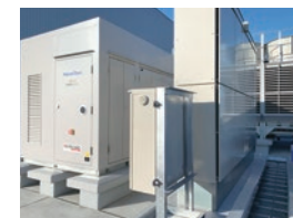
日本デイリーネット（株） 名古屋第二センター ノンフロン冷蔵冷凍装置
