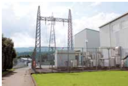
<変圧器ヤード> 構内の電力を除いた約9,000kW（一般家庭約3,000戸分） が電力会社へ送電される。
