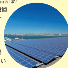
屋上に設置された 太陽光パネル
