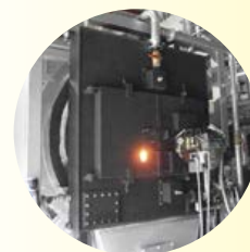
鶏ふんを焼却するボイラー設備
