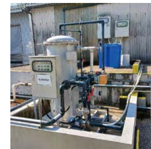
雨水ろ過装置
